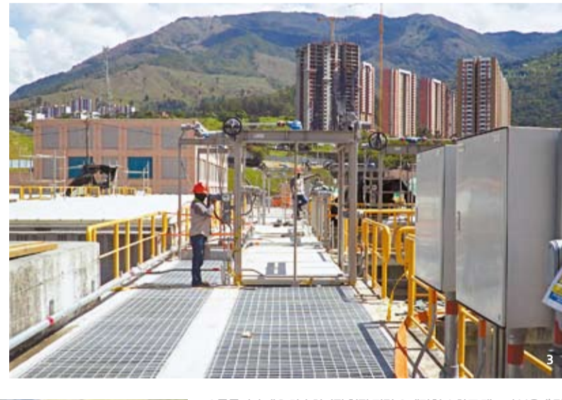
1 콜롬비아 벨로 하수처리장 현장. 2 계란형 소화조 탱크의 보온재 및 알루미늄 커버 시공 모습. 3 근로자들이 기자재 현장 시험(Field Test)을 하고 있다. 4 유입 펌프장 시설. 5 현장은 계란형 소화조 탱크의 시공 단축을 위해 200t 크레인을 사용했다. 사진은 크레인으로 소화조 철관을 인양하는 모습.
