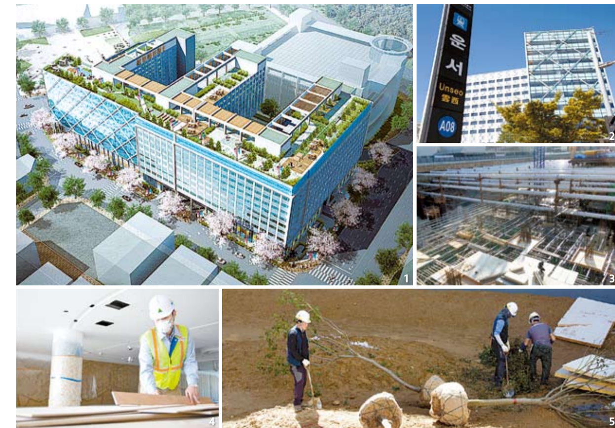
1 'E'자형 설계가 돋보이는 메가스타 영종의 조감도. 2 현장은 운서역 1번 출구 맞은편에 위치해 있다. 3 토공사와 지하 골조공사 병행 모습. 4 인터리어 마감 자체 근무 모습. 5 근로자들이 조경 식재를 심고 있다.
