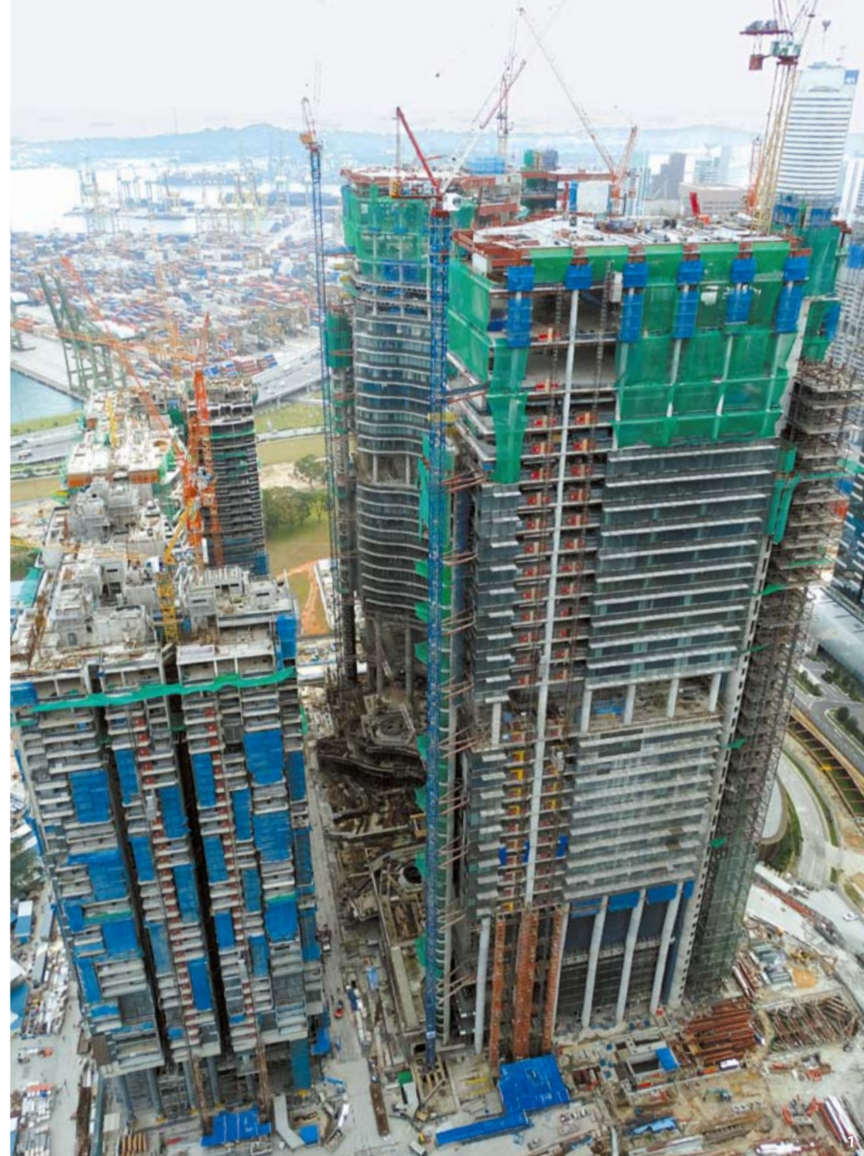
1 싱가포르 마리나 사우스 복합개발 현장 전경. 2 직원들이 현장에서 시공 도면을 체크하고 있다. 3 사무동 커튼월 전경. 4 중앙부 조정공간 조경도. 5 일일안전조회 모습.
